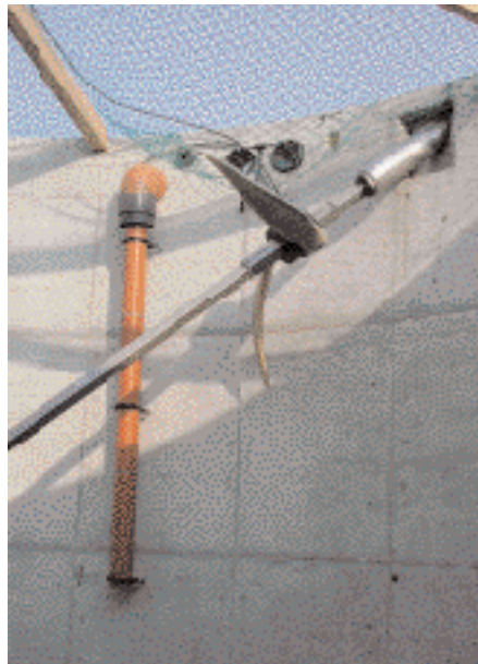
Durch langsam laufende Rührwerke mit großen Durchmessern wird versucht, die Effizienz der Biogasanlagen zu steigern, indem eine homogene Durchmischung im Fermenter erreicht wird.
